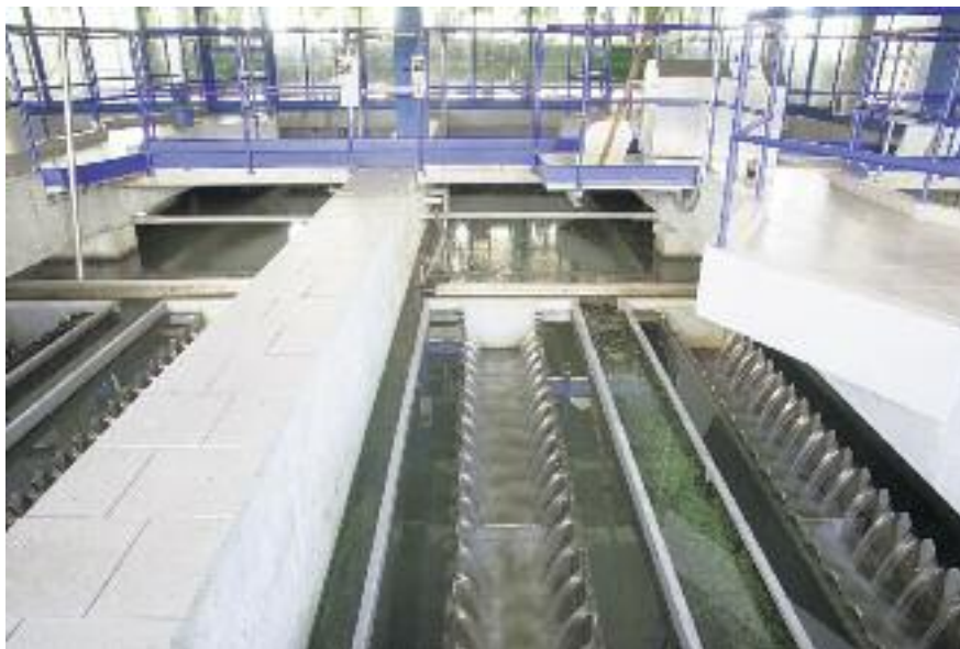
Pomieszczenie koagulacji, gdzie następuje jeden z procesów oczyszczenia wody
